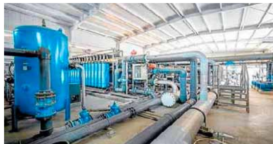
Depuradora de agua en Almería. R. I.
