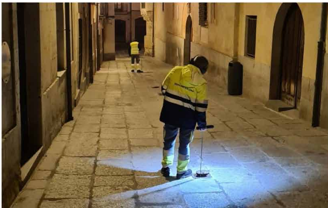
Control de fugas de agua. Ayto de Salamanca
